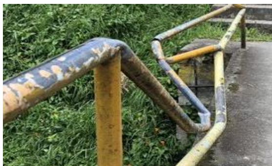
Deformación por Impacto de un Puente Peatonal
