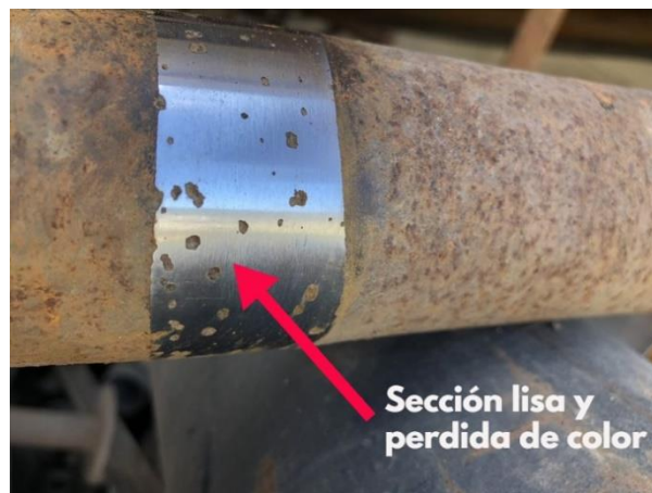
Desgaste Físico de Elemento Metálico
