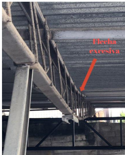
Deformación por Sobrecarga en Cercha
