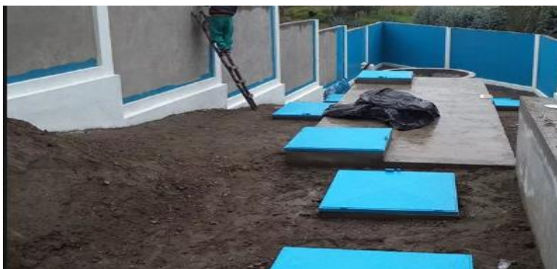
Figura 5. Planta de Agua Potable Fuente: Investigación directa (Autor)
