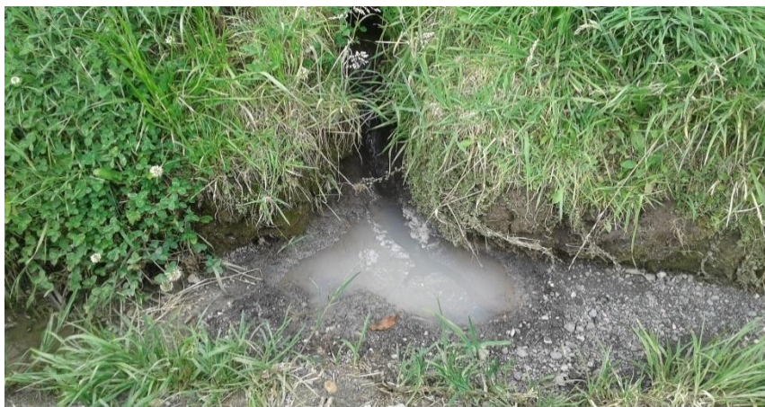
Figura 6. Alcantarillado Colapsado Fuente: Investigación directa (Autor)
