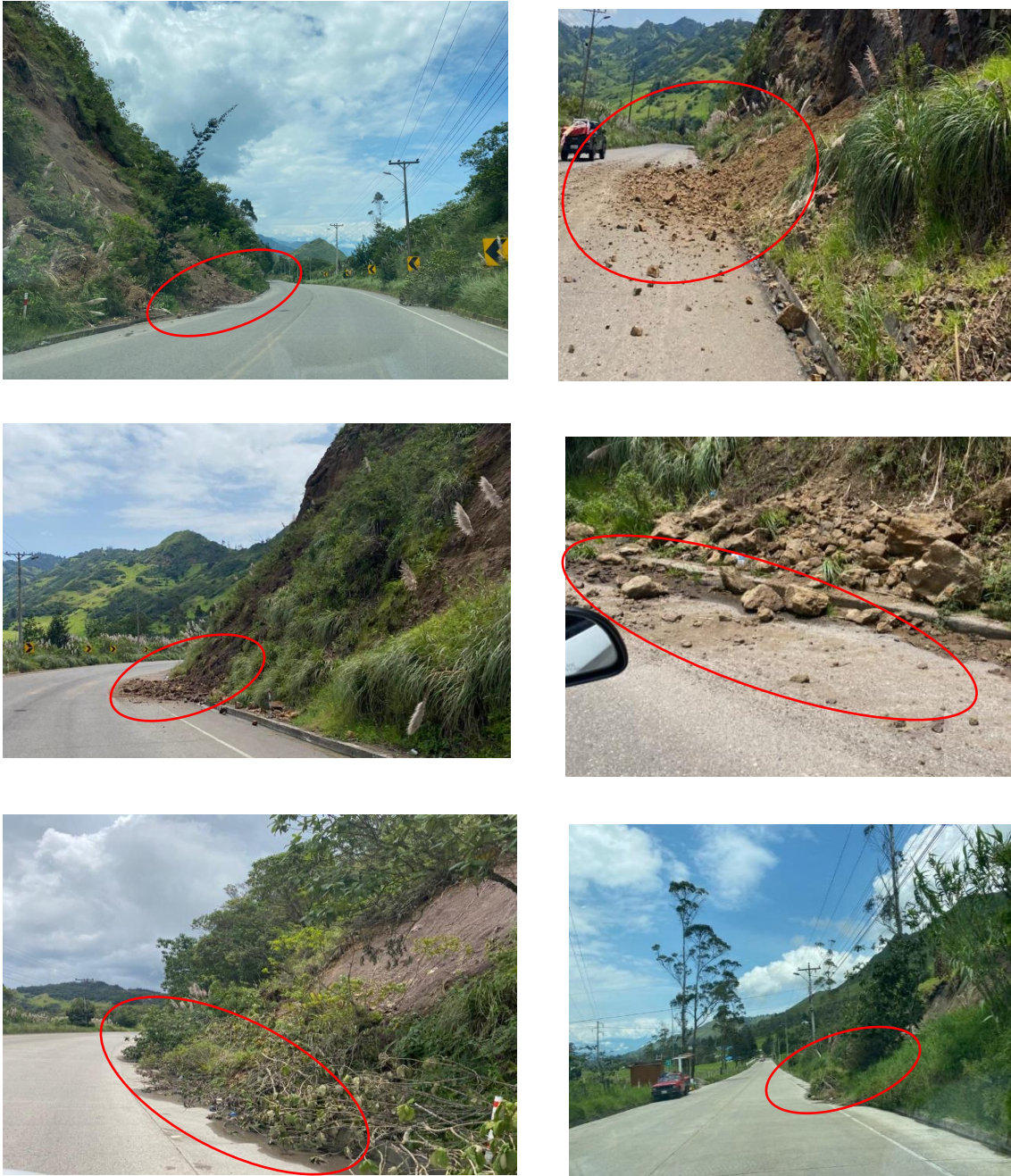
Ilustración 7 Derrumbes en varios tramos de la vía Fuente: Propia
