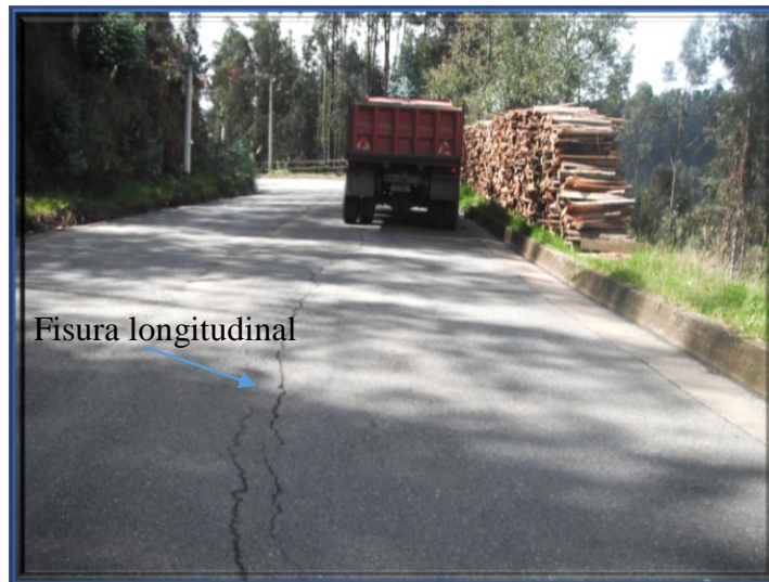
Fotografía 5. Fisura longitudinal ubicada en el carril derecho, abscisa 6+600
