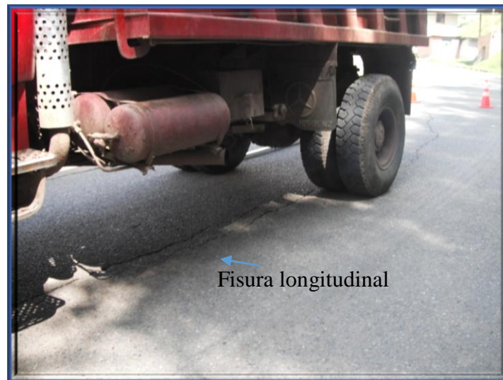
Fotografía 3. Fisura longitudinal, abscisas 6+500
