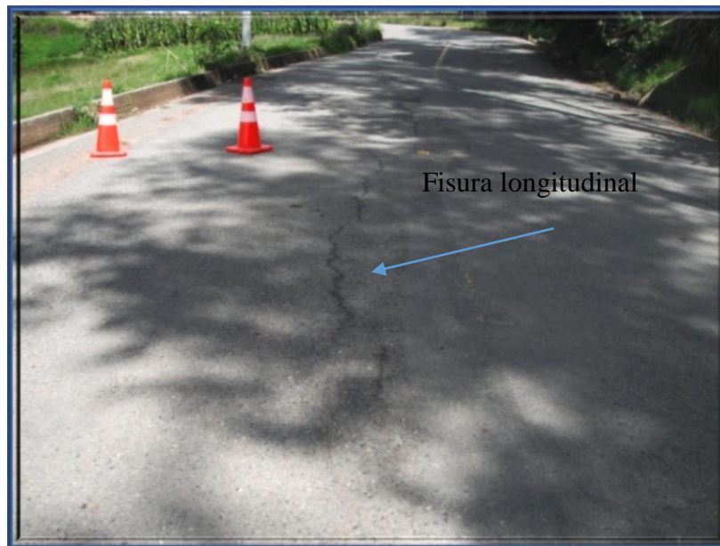
Fotografía 6. Fisura longitudinal, abscisas 6+400
