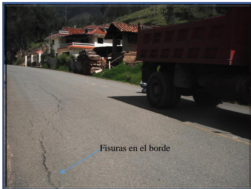
Fotografía 12. Fisuras en el borde, abscisas 5+052
