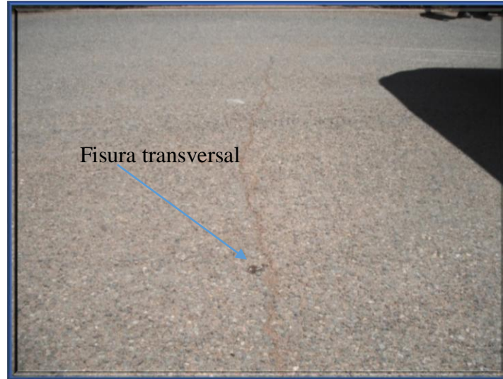
Fotografía 2. Fisura Transversal, abscisas 6+400
