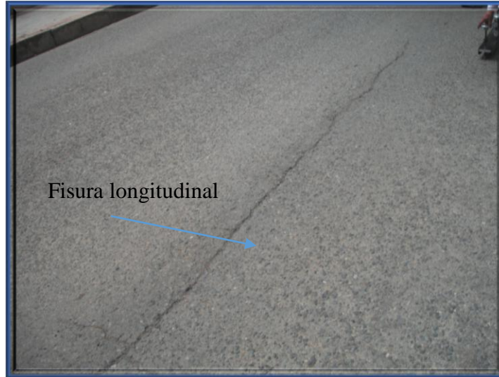
Fotografía 4. Fisura longitudinal, abscisas 3+400
