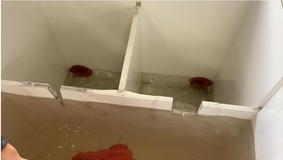
Fotografía 17. Paso de agua por vertederos y salidas por tuberías de PVC 50mm Elaborado Por: Álvaro Ávila
