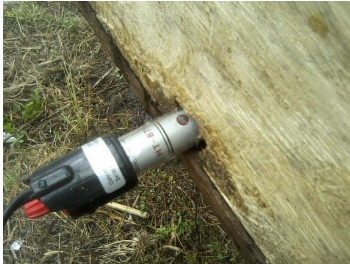
Fotografía 1. Instalación de los termocalentadores.
