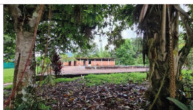
Deterioro de la infraestructura. Fuente: Propia
