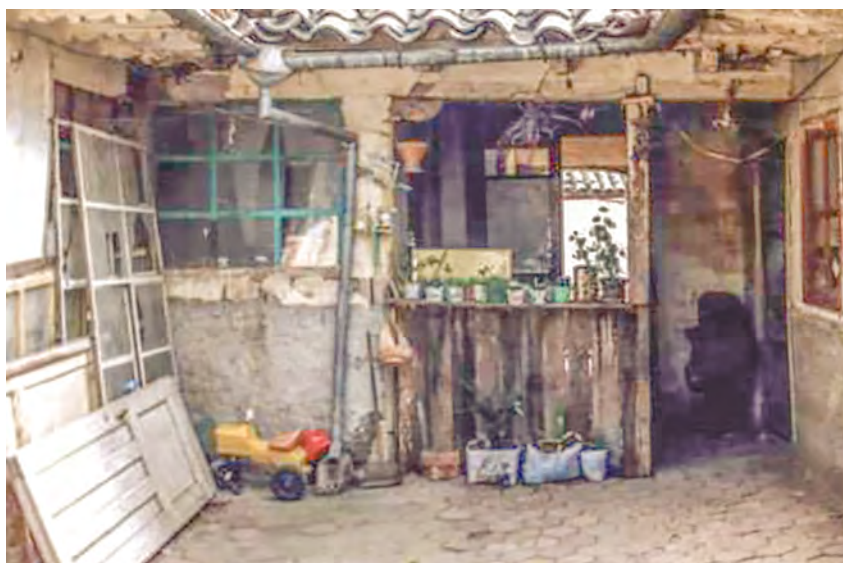
FIGURA 2.2: Centro Cultural El Prohibido, Interior de primer patio anterior a intervención. Fuente: Templo Arutam (s.f), https://www.facebook.com/media/set/?set=a.1783830648516900&type=3 . Elaboración: Moscoso, 1994.
