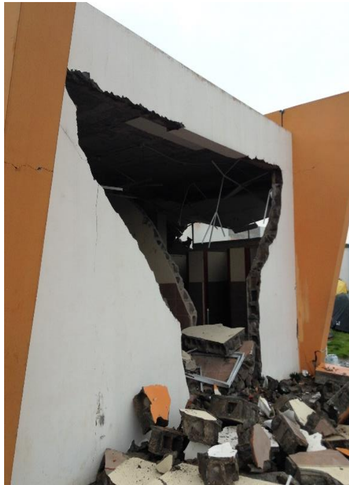
Ilustración 34. Fracaso de mampostería en Escuela del Milenio – Pedernales Ecuador
