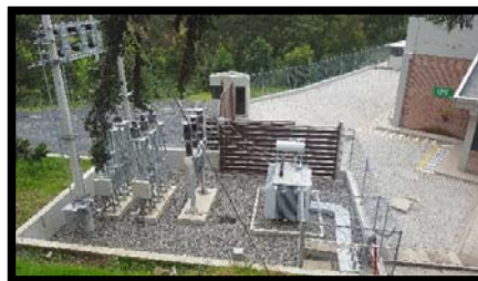
Fotografía 50. Repartidor de energía subestación.
