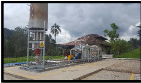
Fotografía 49. EBE, Central de generación de Electricidad Bio-procesador.
