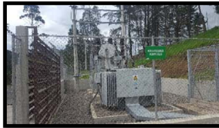
Fotografía 46. EBE, subestación Eléctrica.
