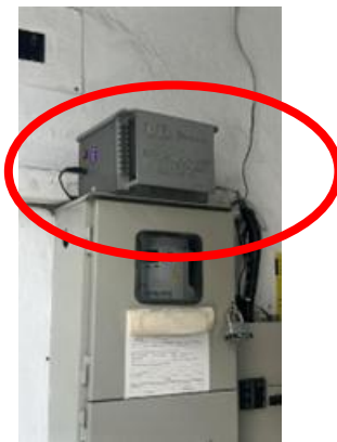
Figura 11: Dispositivo instalado para la medición y registro de parámetros de calidad del aire en la calle Tarqui y Mariscal Lamar
