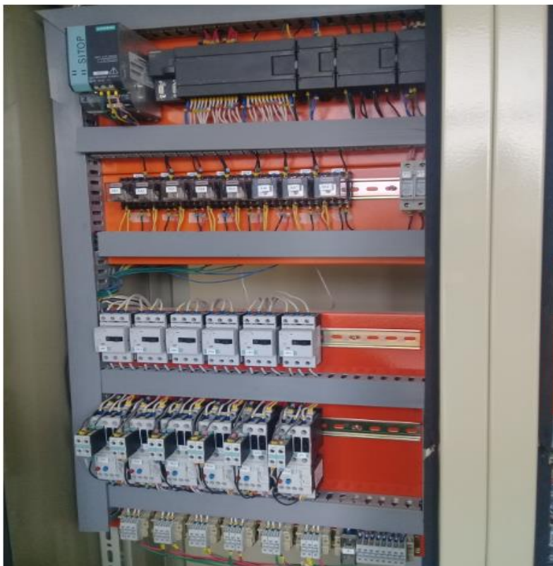
Figura 3.16 Armario de centralización de equipos de control y adquisición, Fuente: Cortesía EMAPAL-EP
