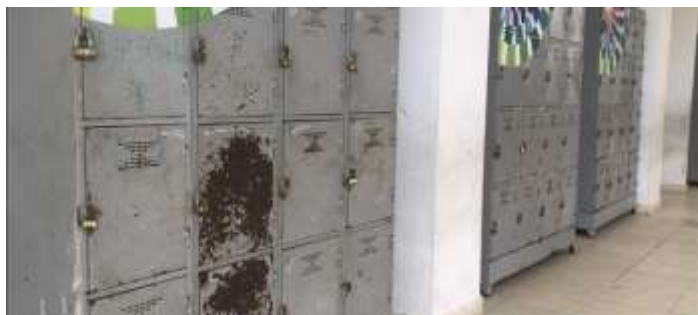
Figura 11: Daños en las Escuelas del Milenio.
