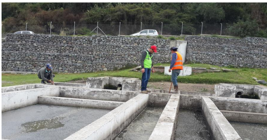
Vista Panorámica del tanque Imhoff / PTAR la Libertad – Riobamba.
