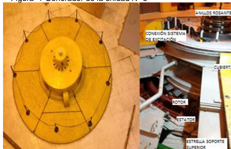
Figura 1 Generador de la unidad N° 5
