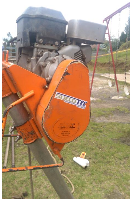
Foto 20: Motor empleado para elevar la carga. Fuente propia.
