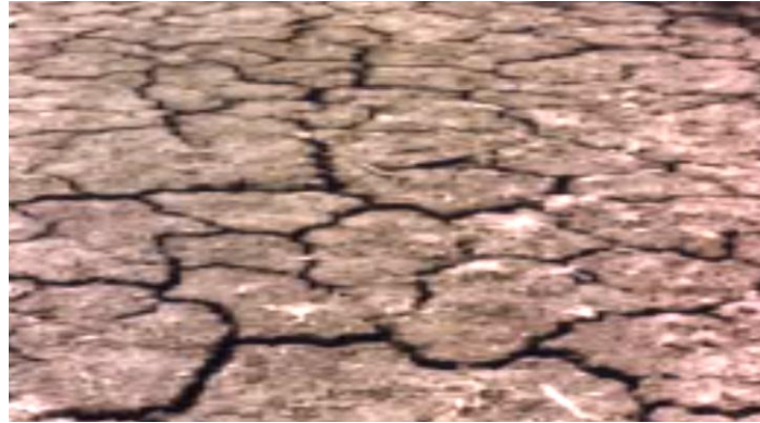
Foto 11: Grietas presentes, durante inspección visual, sector Nulti. Fuente propia.
