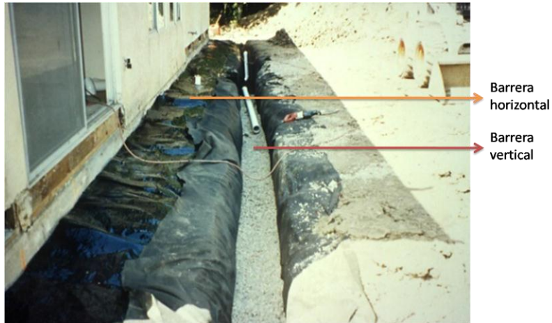
Foto 13: Barrera horizontal y vertical para control de humedad del suelo. Fuente propia.
