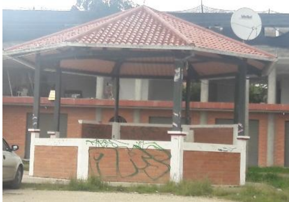
Foto N° 31: Glorieta en mal estado Fuente y Elaboración: Pedro L. Tierra A.
