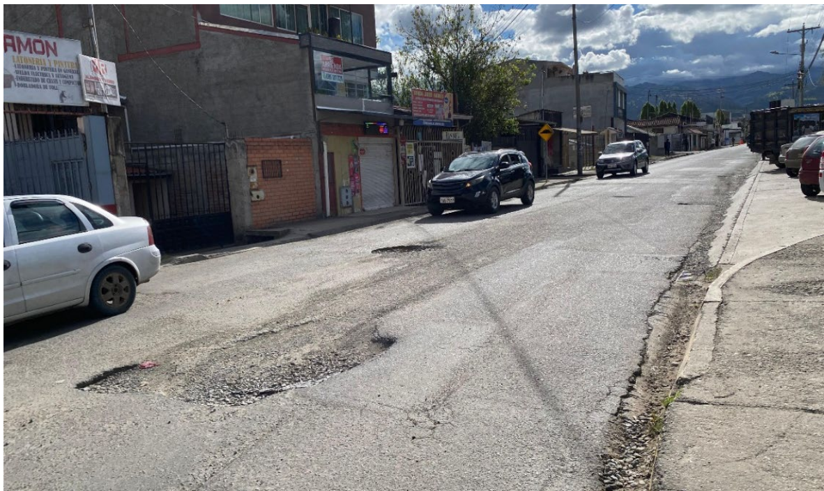
Figura 33 Fotografías Estado Vial vía a San Miguel
