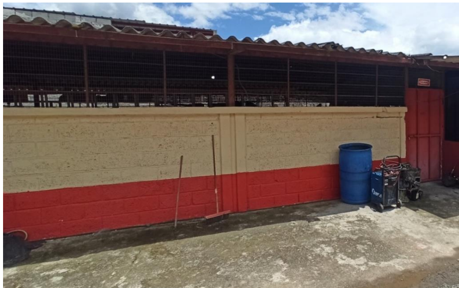
Figura 111. Falta de enlucidos Elaboración propia
