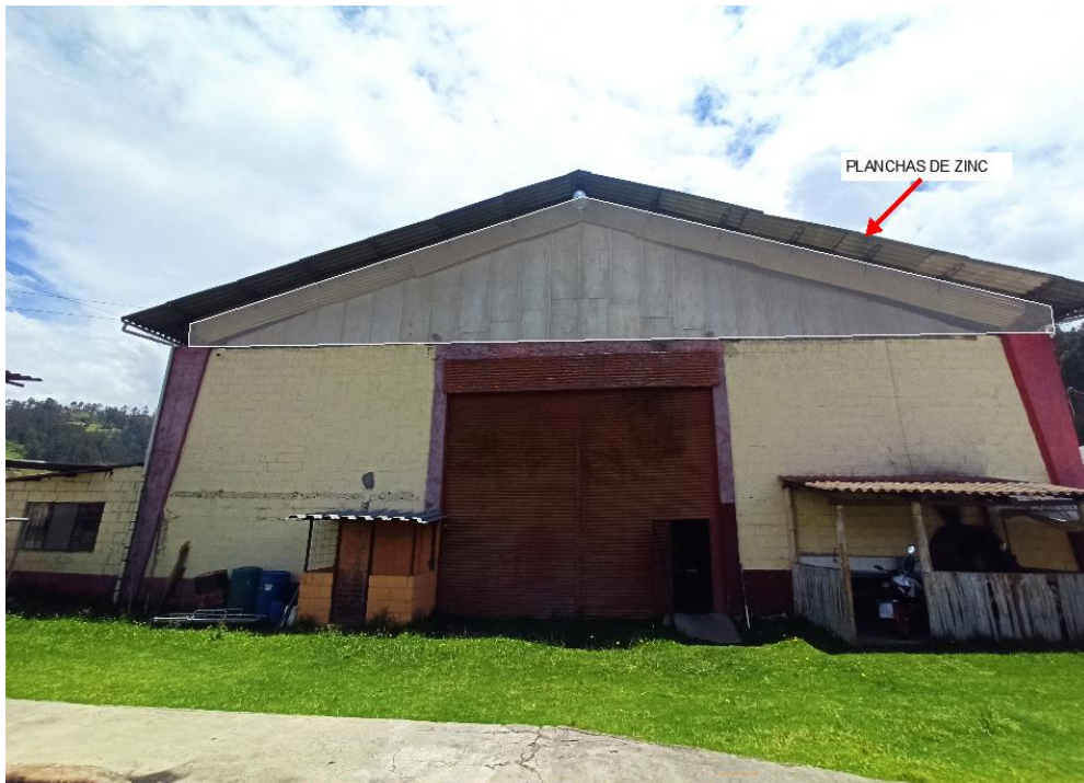
Figura 110. Uso provisional de planchas de zinc en frontón de la fachada posterior Elaboración propia
