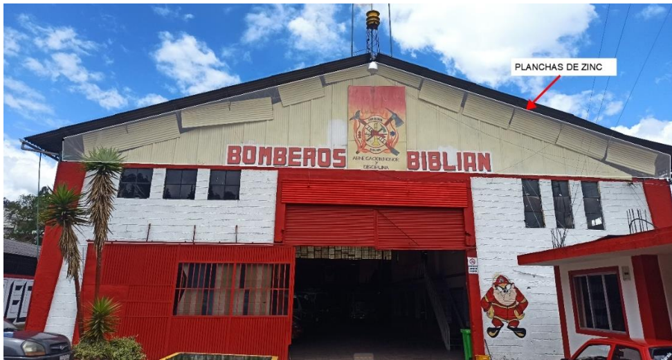
Figura 109. Uso provisional de planchas de zinc en frontón de la fachada frontal Elaboración propia
