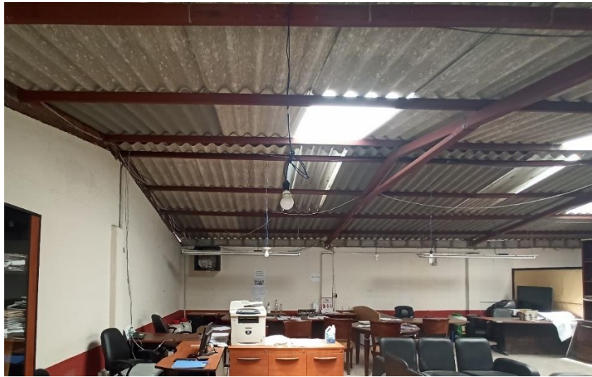
Figura 112. Falta de cielo rasos Elaboración propia
