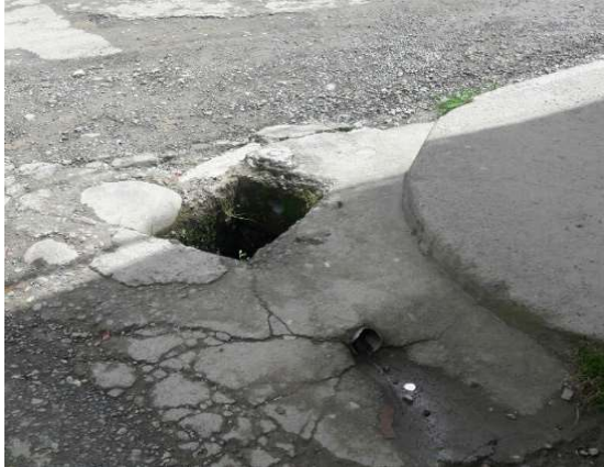
Ilustración 4: Rejillas de aguas lluvia en mal estado. Fuente: Autores.
