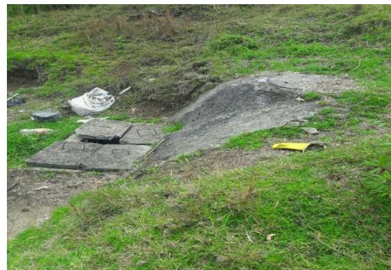
Ilustración 9: Entrada de las aguas residuales en mal estado.
