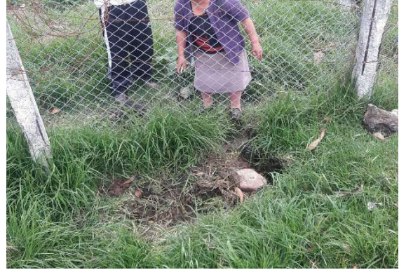
Ilustración 10: Salida de las aguas residuales a un terreno colindante. Fuente: Autores.
