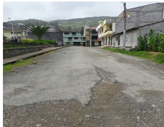
Ilustración 4: Evidencia del sistema sanitario actual (Faltan pozos de revisión).
