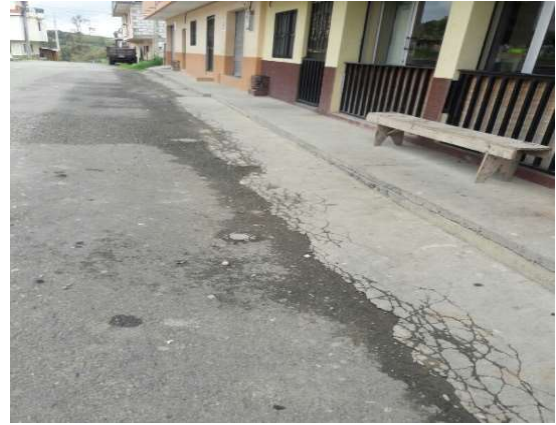
Ilustración 3: Evidencia de falta de un sistema de alcantarillado pluvial. Fuente: Autores.
