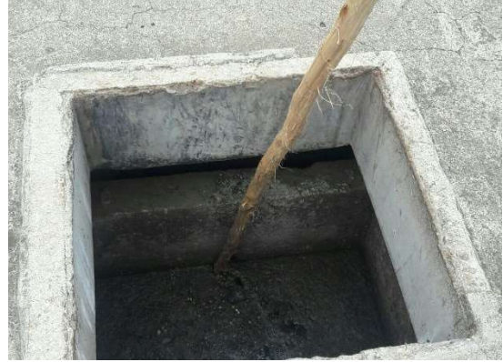
Ilustración 13: Fosas Sépticas de la planta de tratamientos de aguas residuales. Fuente: Autores.
