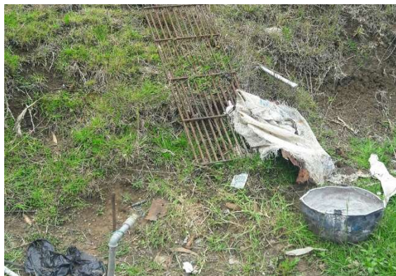
Ilustración 8: Rejilla para retención de sólidos se encuentra fuera de su sitio.
