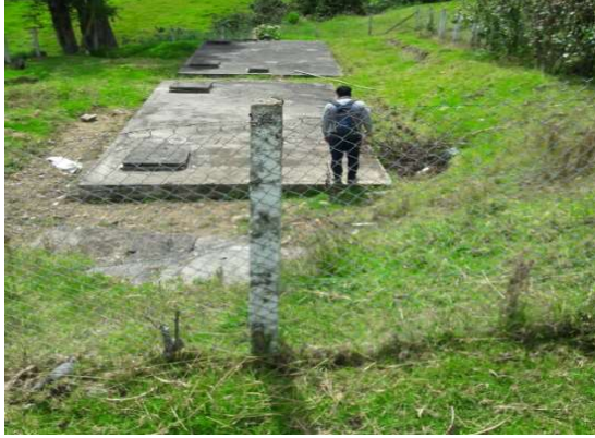
Ilustración 14: Planta de tratamientos de aguas residuales de Daniel Córdova Toral. Fuente: Autores.
