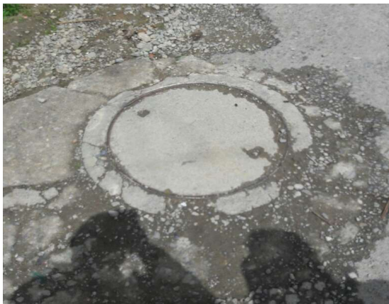
Ilustración 3: Evidencia del sistema sanitario actual (Faltan Pozos de revisión).
