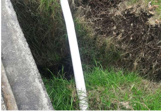
Ilustración 11: Desvío de las aguas residuales directamente a la salida. Fuente: Autores.
