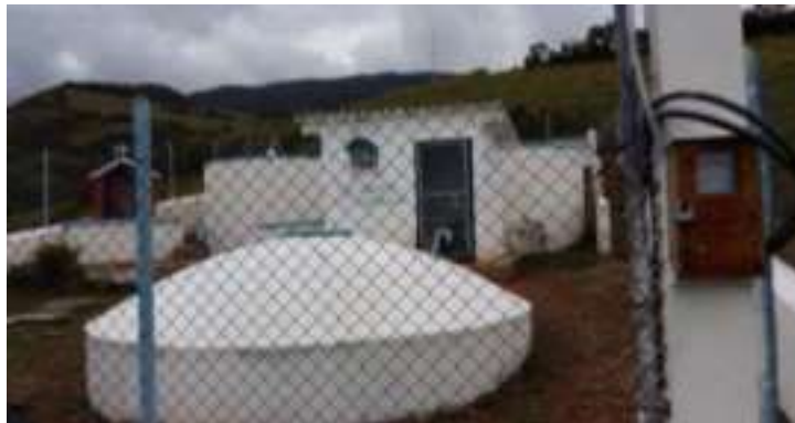
Ilustración 15: Planta de tratamiento de agua potable Fuente: Autores.
