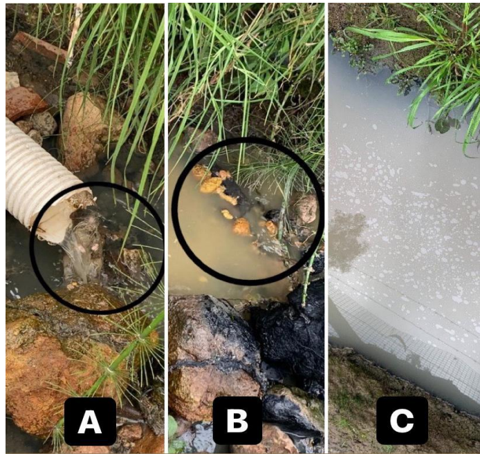
Ilustración 14: Roedores, heces fecales, aceites y grasas en las aguas residuales de la quebrada Huizhil.
