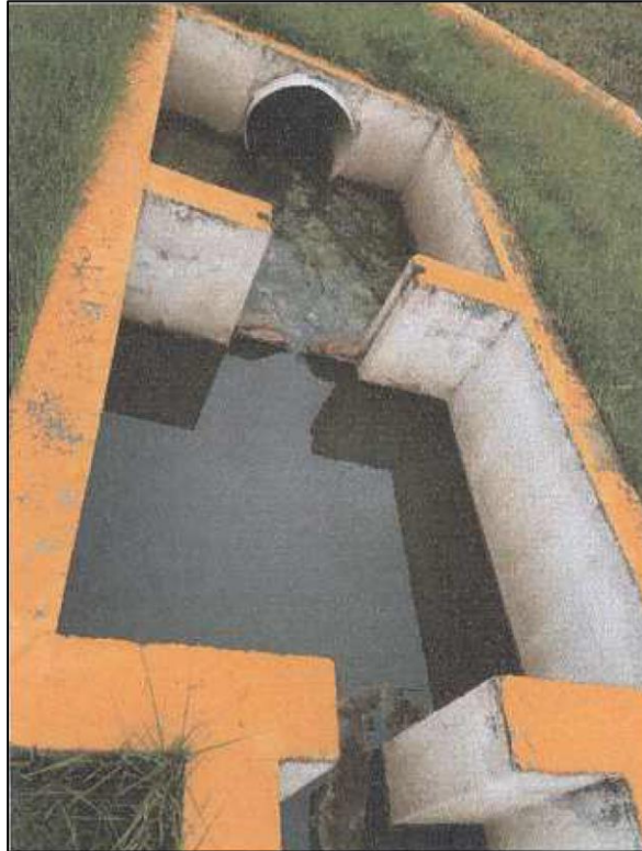
Figura 26: Decantador de la planta de tratamiento de lixiviados.
