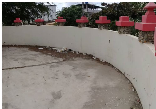
FIGURA 2.115: Foto 116. Contaminación en balcón. Fuente: Propia
