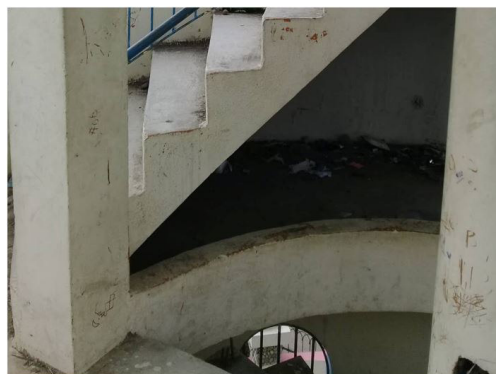
FIGURA 2.116: Foto 117. Contaminación debajo de escalera. Fuente: Propia
