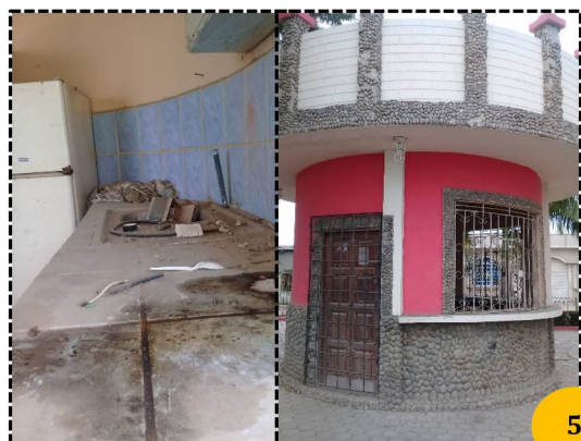
FIGURA 2.45: Foto 46. Bar abandonado. Fuente: Propia
