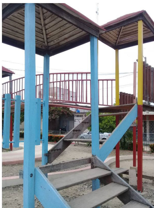
FIGURA 2.113: Foto 114. Casa de juegos destruida. Fuente: Propia
