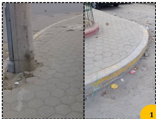
FIGURA 2.41: Foto 42. No existen rampas Fuente: Propia
