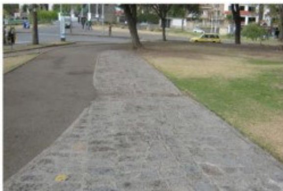
FIGURA 1.22: Foto7. Caminerías en mal estado. Fuente: Fundación El Barranco
