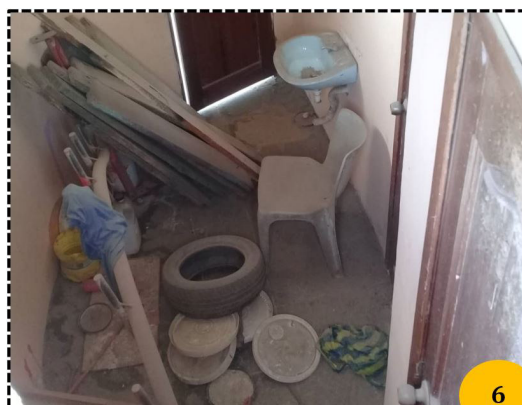
FIGURA 2.46: Foto 47. Baterías sanitarias abandonadas. Fuente: Propia
