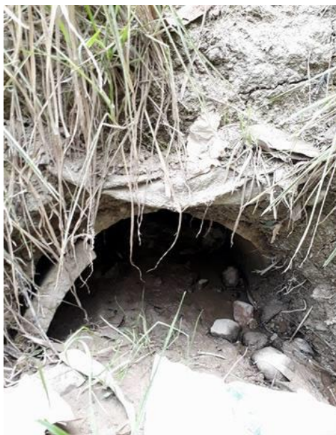
Fotografía 11. Alcantarillas en malas condiciones en estructura y mantenimiento.
