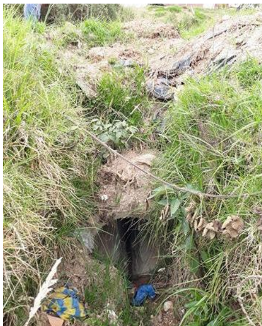
Fotografía 12. Alcantarillas sin mantenimiento.
