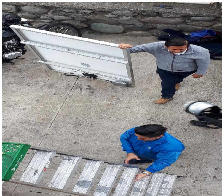
Figura 35. Montaje del Inversor ya listo para colocarlo sobre el tejado. Fuente: (Autores)
