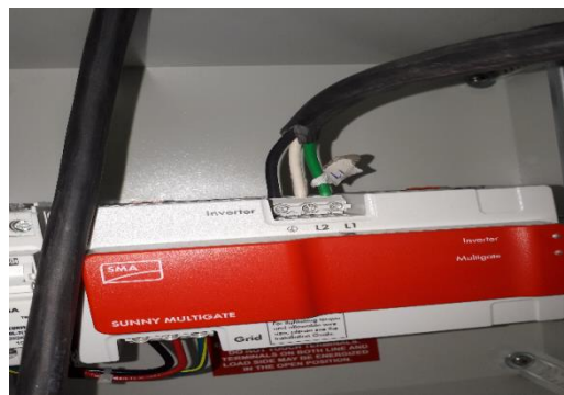
Figura 38. Montaje de Sunny Multigate. Fuente: (Autores)
