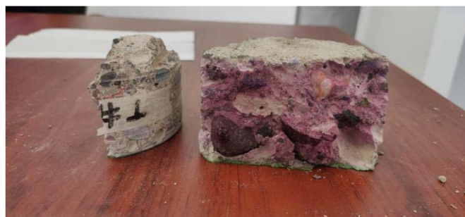
Ilustración 55. Presencia de Carbonatación muestra #1
