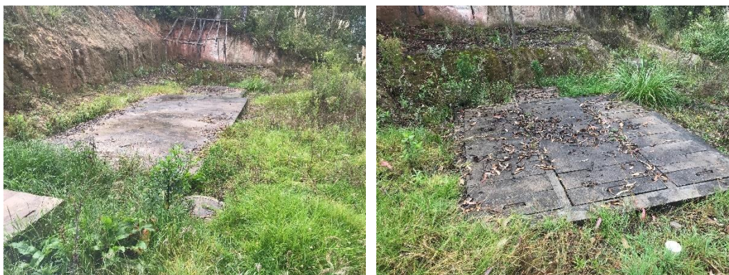
Ilustración 11 Estado actual de la PTAR ubicada en el sector Quillopungo.
