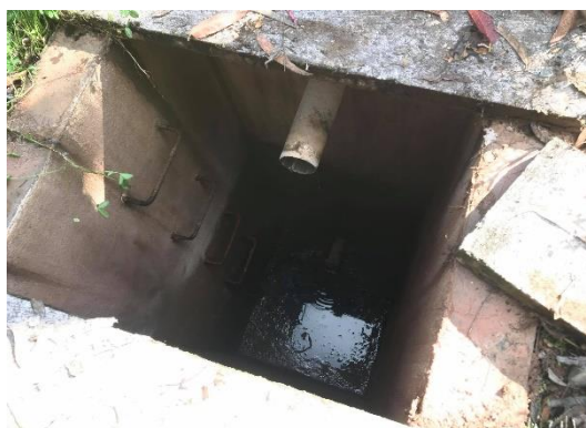
Ilustración 13 Caja de revisión de la PTAR ubicada en el sector de Quillopungo.
