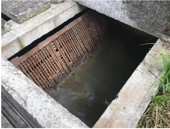
Estado de la rejilla de la PTAR del sector de María Auxiliadora.
