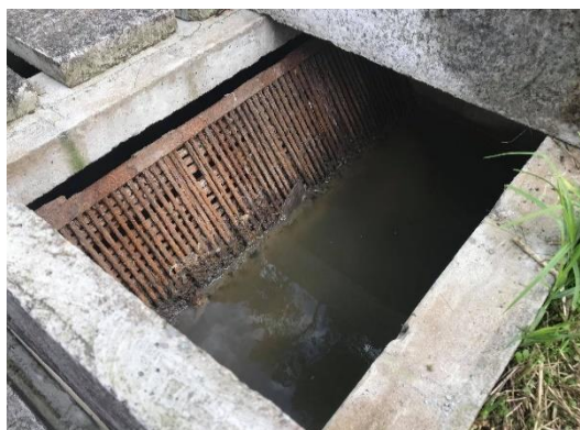
Ilustración 9 Estado de la rejilla de la PTAR ubicada en el sector de María Auxiliadora.
