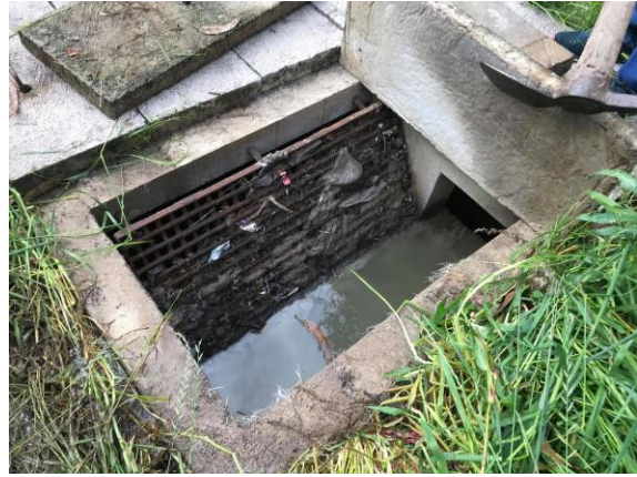
Estado de la rejilla de la PTAR del sector de Quillopungo.
