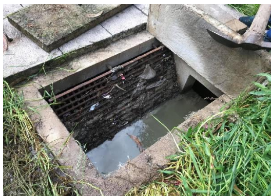
Ilustración 12 Estado de la rejilla de la PTAR ubicada en el sector de Quillopungo.
