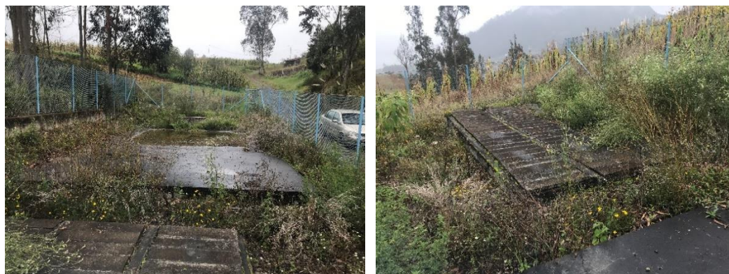
Ilustración 8 Estado actual de la PTAR ubicada en el sector de María Auxiliadora.
