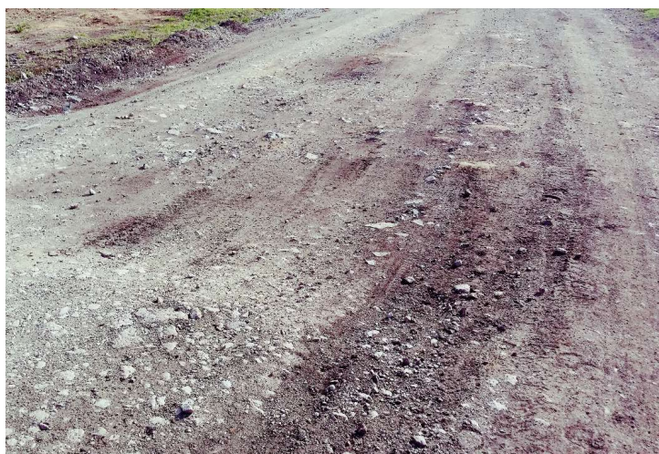
Figura 5. Asentamiento en la vía en la abscisa 5+141. Fuente: Elaboración propia.
