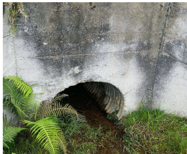
Figura 24. Alcantarilla tubo de acero corrugado galvanizado. Fuente: Elaboración Propia.
