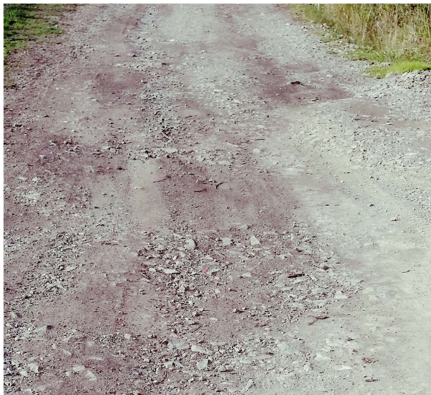
Figura 4. Asentamiento en la vía en la abscisa 4+001. Fuente: Elaboración propia.
