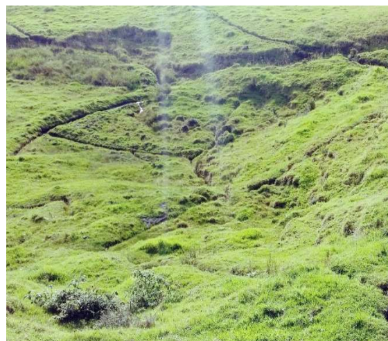
Figura 2. Afloramiento de agua en la abscisa 5+061. Fuente: Elaboración Propia.
