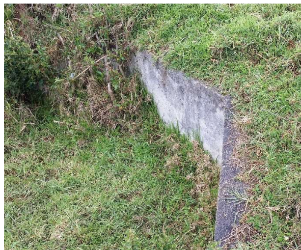
Figura 22. Alcantarilla obstaculizada. Fuente: Elaboración propia.
