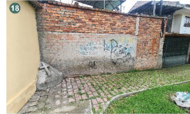
18 Muros colindantes en pesimo estado utilizados como urinarios.
