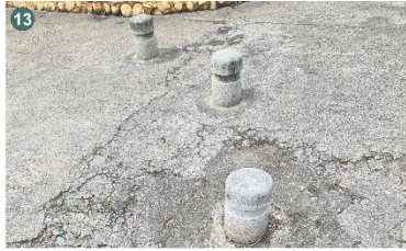
13 Bordillos y losa de hormigón en mal estado.
