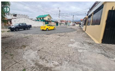
19 Losa de hormigón de acceso al parque en mal estado.
