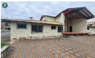
7 Casa comunal en deterioro de su mampostería de ladrillo y ventanas rotas.
