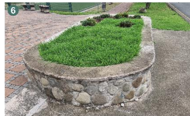
6 Espacio destinado para vegetación en mal estado.
