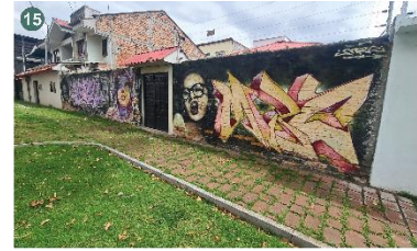
15 Paredes de colindante con signos de vandalismo.
