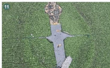
11 Equipamiento deportivo (Cancha sintética) en deterioro.
