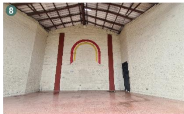
8 Concha acústica en deterioro y habitado por personas mal intencionadas.
