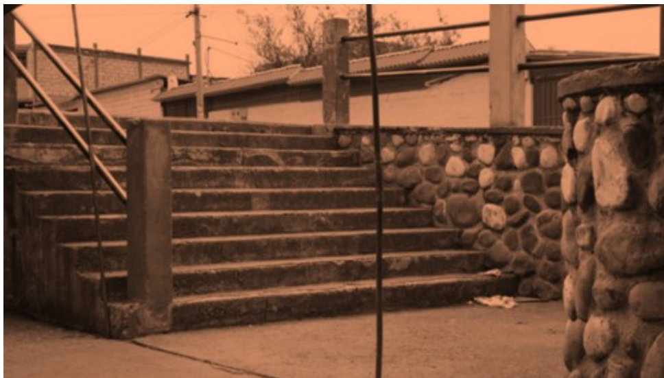
FIGURA 2.23: Problemática, Mal diseño de gradas. Fuente: Fotografía benarm.
