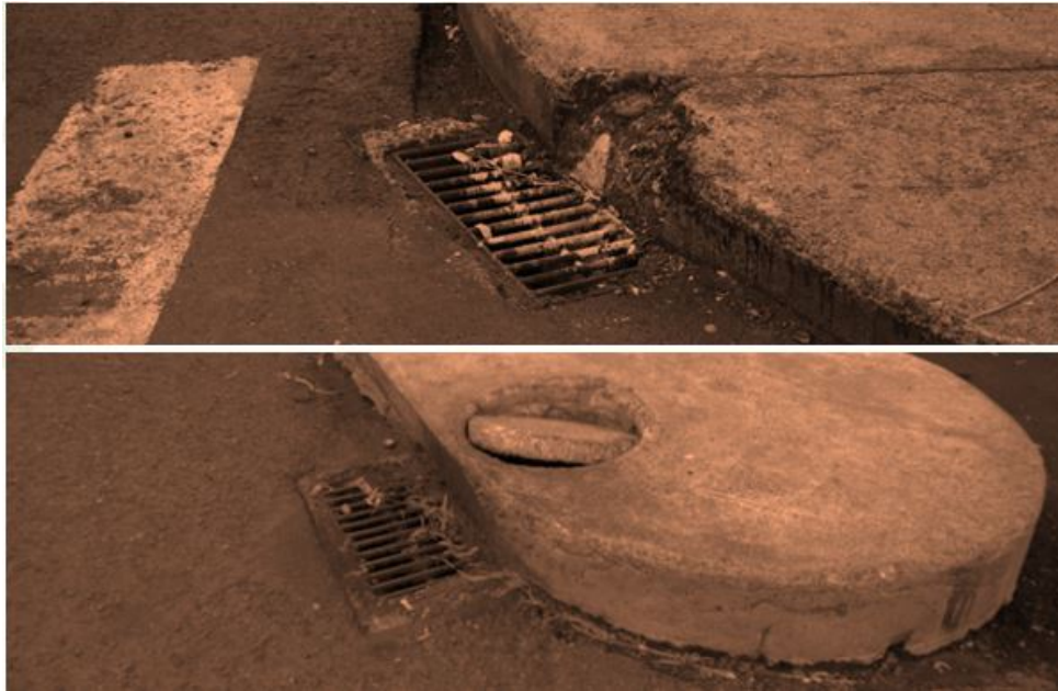
FIGURA 2.24: Problemática, Mal diseño de gradas. Fuente: Fotografía benarm.
