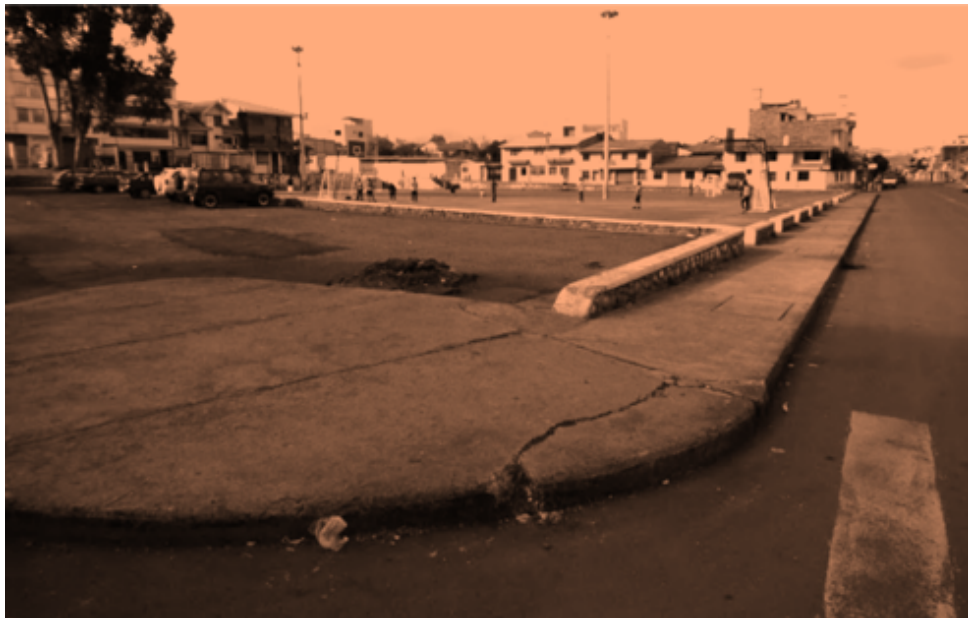
FIGURA 2.25: Problemática, veredas deterioradas. Fuente: Fotografía benarm.
