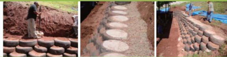
IMAGEN 10: Compactación manual entre las llantas y la pendiente, la tapa de mortero en el último nivel de neumático.
