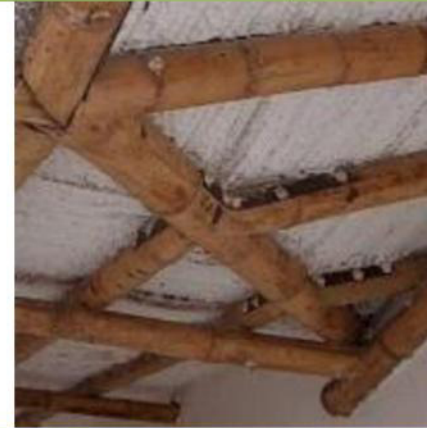
IMAGEN 25: Uniones con platinas de acero.
