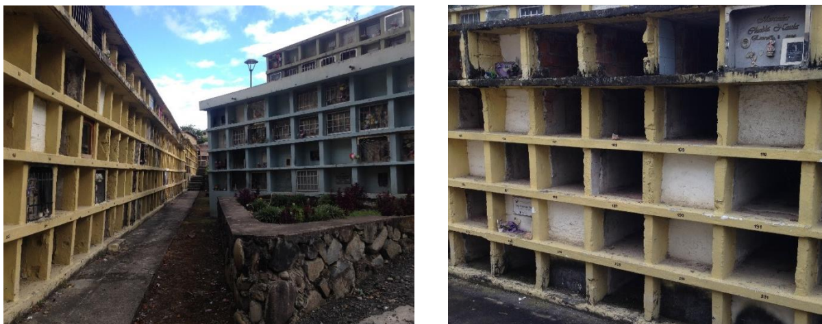
Ilustración 65 Estado actual de las bóvedas de la zona este del cementerio
