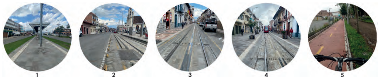
FIGURA 2.15: Estado de estaciones tranviarias
