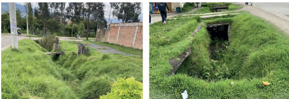
FIGURA 2.37: Estado de la quebrada San Miguel
