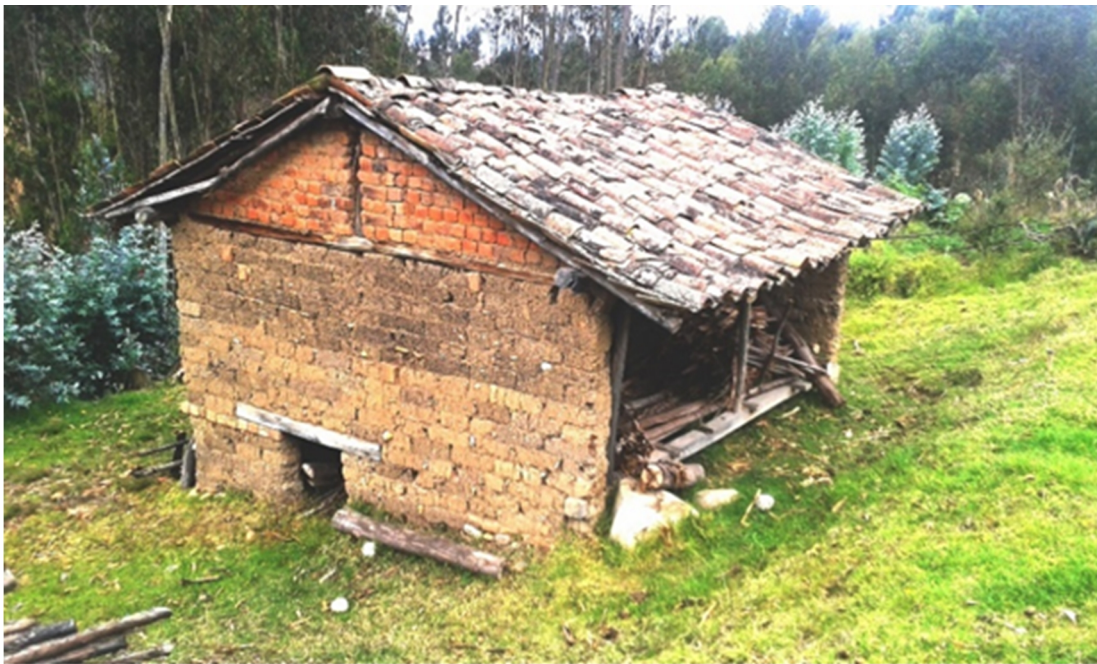
Foto N° 11: Casa vernácula en deterioro utilizada para bodega.
