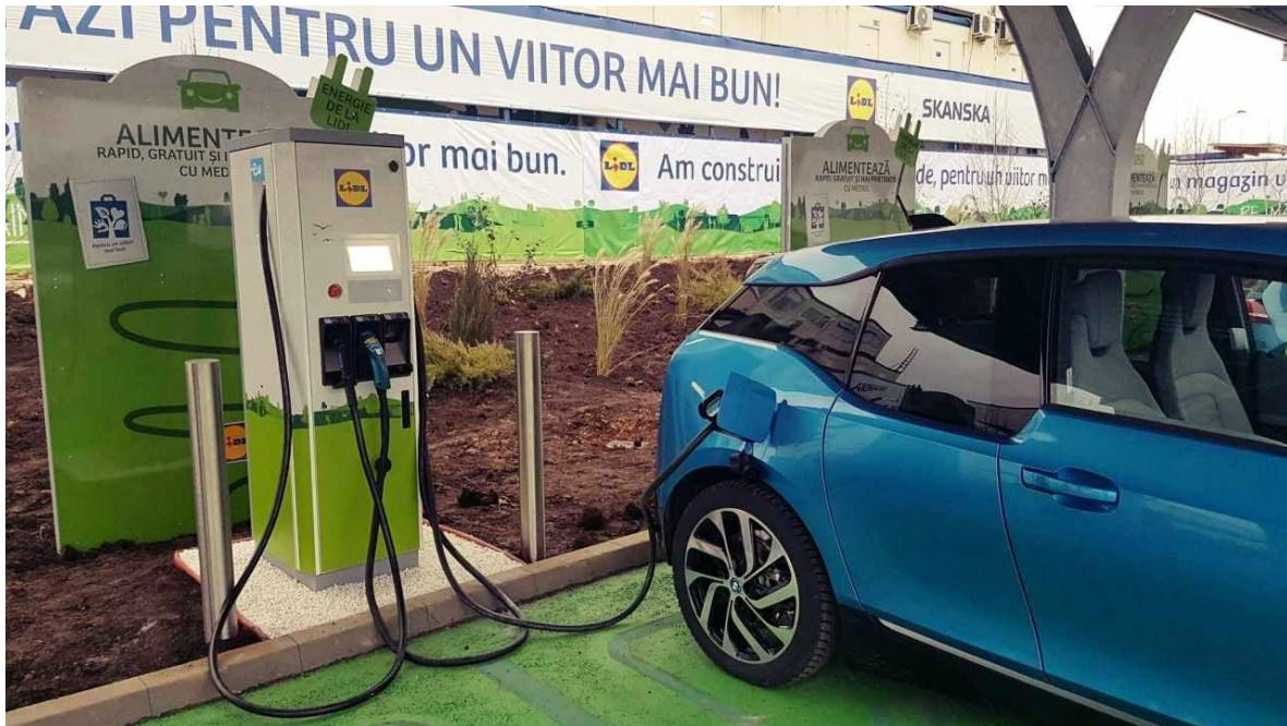
Figura 3. Electrolinera Interna Fuente: (Universidad Internacional del Ecuador, 2022)
