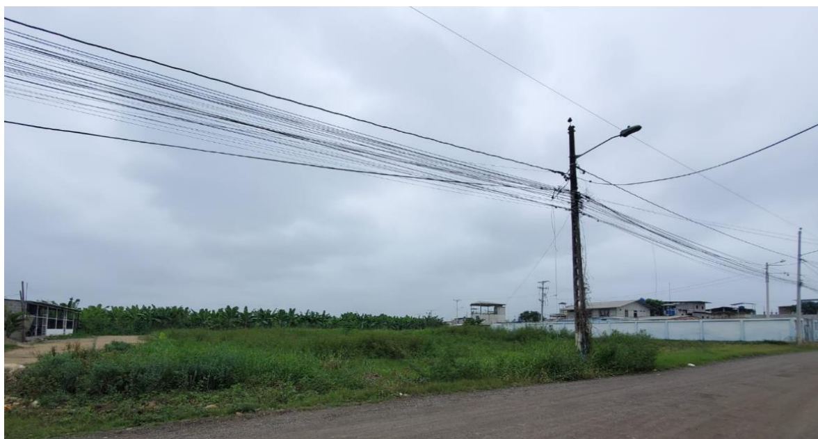
Figura 76: Iluminación dentro del Terreno a intervenir
