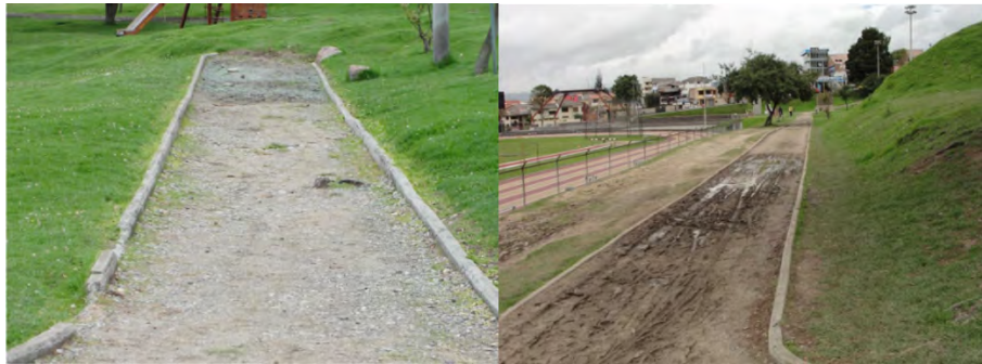
FIGURA 2.37: Se puede observar que las caminarias del parque se encuentran en muy mal estado por la falta de mantenimiento y descuido del GAD, causando destrucción y empozamientos, llegando a causar una mala imagen para el sector y circulación para los usuario. Fuente: Villavicencio (2015)
