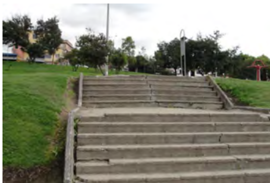
FIGURA 2.38: Se observa el deterioro de las gradas, por la falta de mantenimiento llegando a causar trizaduras y desprendimiento del hormigon. Esto llega a causar algo negativo para el parque y la ciudad, ya que se encuentran ubicada al frente de la via mas transitada de Cuenca que es la Av. De las Ámericas. Fuente: Villavicencio (2015)
