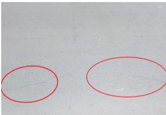
FIGURA 56.- AGRIETAMIENTO DEL PAVIMENTO FLEXIBLE
