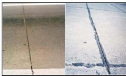
FIGURA 10.-DEFICIENCIA DE SELLADOS
