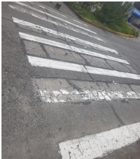
FIGURA 52.-PIEL DE COCODRILO OCASIONADO POR AGRIETACIÓN DEL PAVIMENTO
