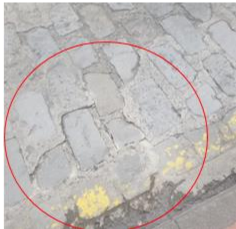
FIGURA 59.-PROBLEMAS DE DRENAJE DEL PAVIMENTO ARTICULADO
