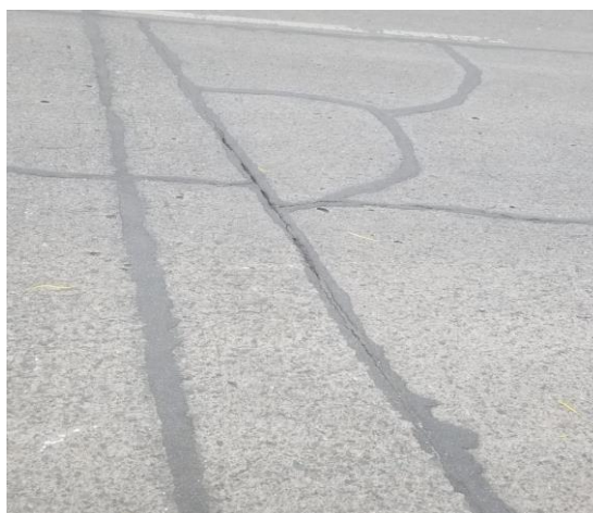
FIGURA 53.-FISURAS TRANSVERSALES POR DEFORMACIÓN DE PAVIMENTO RIGIDO
