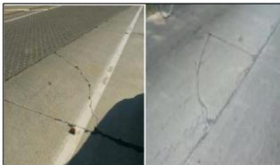
FIGURA 13.-GRIETAS DE ESQUINAS
