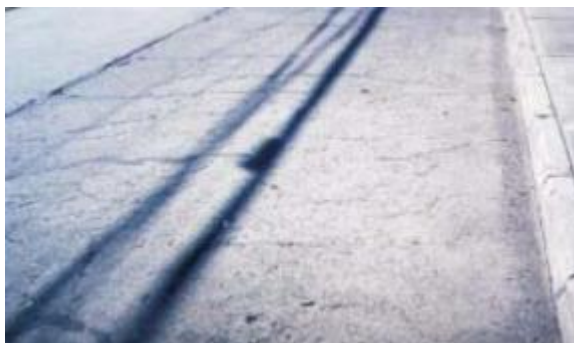
FIGURA 17.-FISURAMIENTO POR RETRACCIÓN
