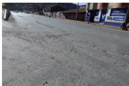
FIGURA 7.- DESINTEGRACIÓN POR PELADURAS
