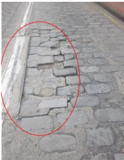
FIGURA 57.- FORMACIÓN DE BACHES DEL PAVIMENTO ARTICULADO
