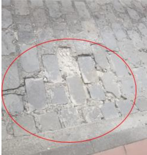
FIGURA 54.- HUNDIMIENTO, DESPLAZAMIENTO, DETERIORO, PERDIDA DE COLOR, FORMACIÓN DE BACHES DE ADOQUÍN.
