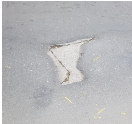
FIGURA 55.- DETERIORO Y BACHEO SUPERFICIAL DE PAVIMENTO FLEXIBLE
