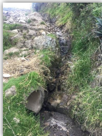
FOTOGRAFÍA 31: TUBERÍA QUE DESEMBOCA FUENTE DE AGUA. Fuente: Propia.
