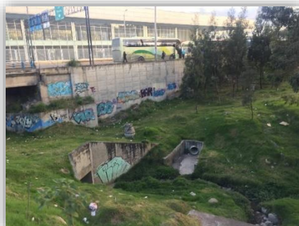
FOTOGRAFÍA 29: VANDALISMO Fuente: Propia.
