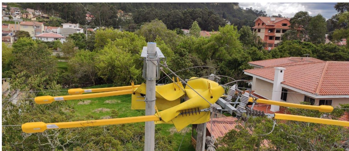
Equipos de protección de red y estructura de Medio Voltaje
