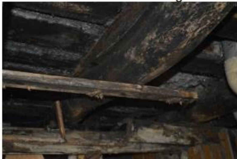
Figura 7. Deformación de la Viga debido a una Sección Insuficiente.
