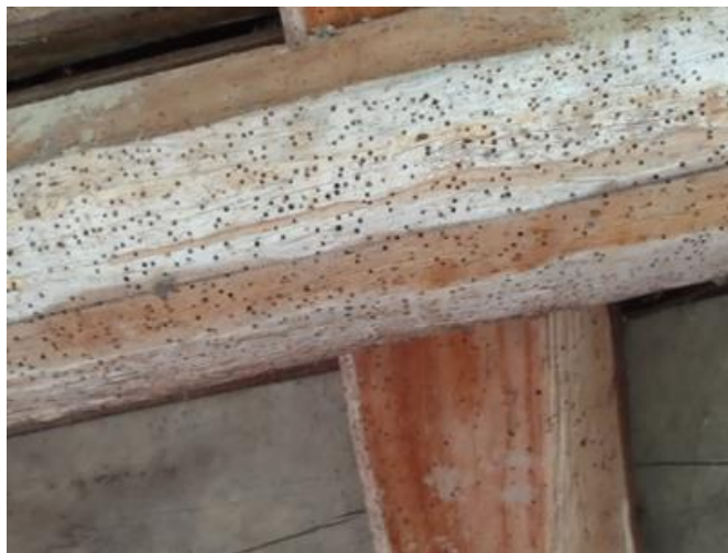
Figura 16. Madera afectada por organismos xilófagos.
