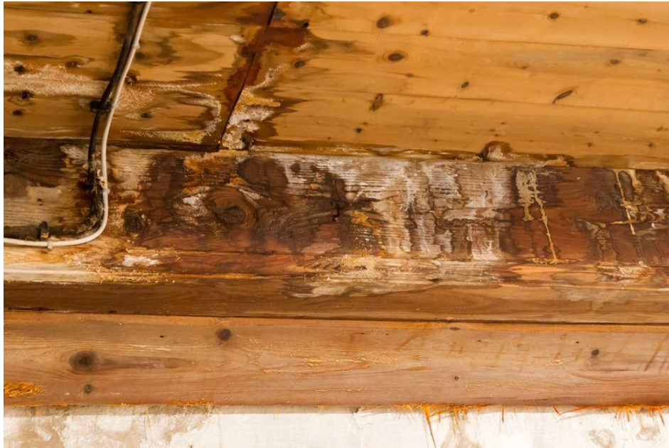
Figura 8. Deformación por Humedad de la Madera.
