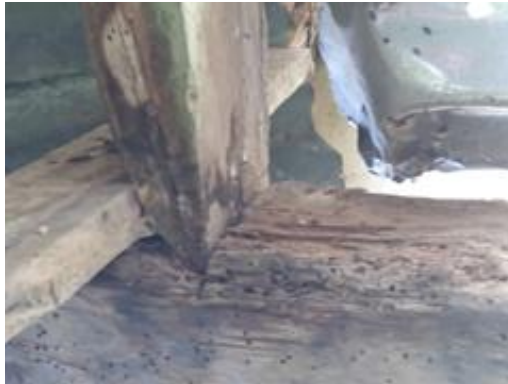
Figura 20. Uniones mal diseñadas.
