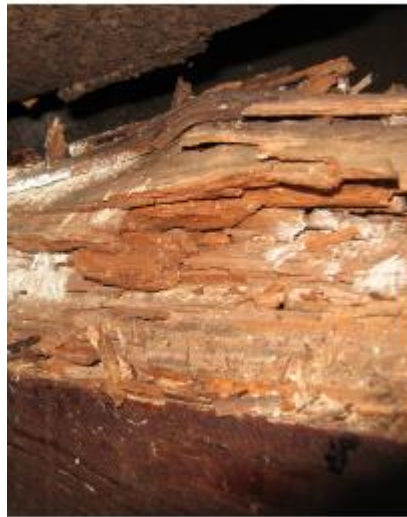
Figura 15. Presencia de Hongos Xilófagos, Pudrición Parda o Cúbica.
