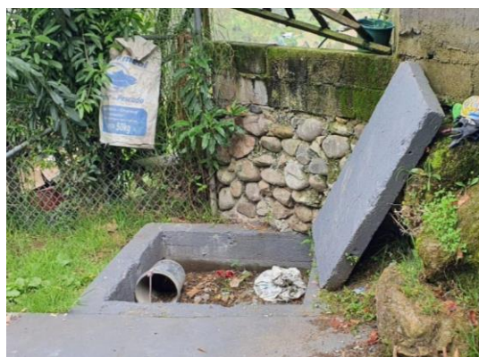
Figura 9: Fosa de secado de la PTAR "Laureles" de la parroquia Santa Ana.
