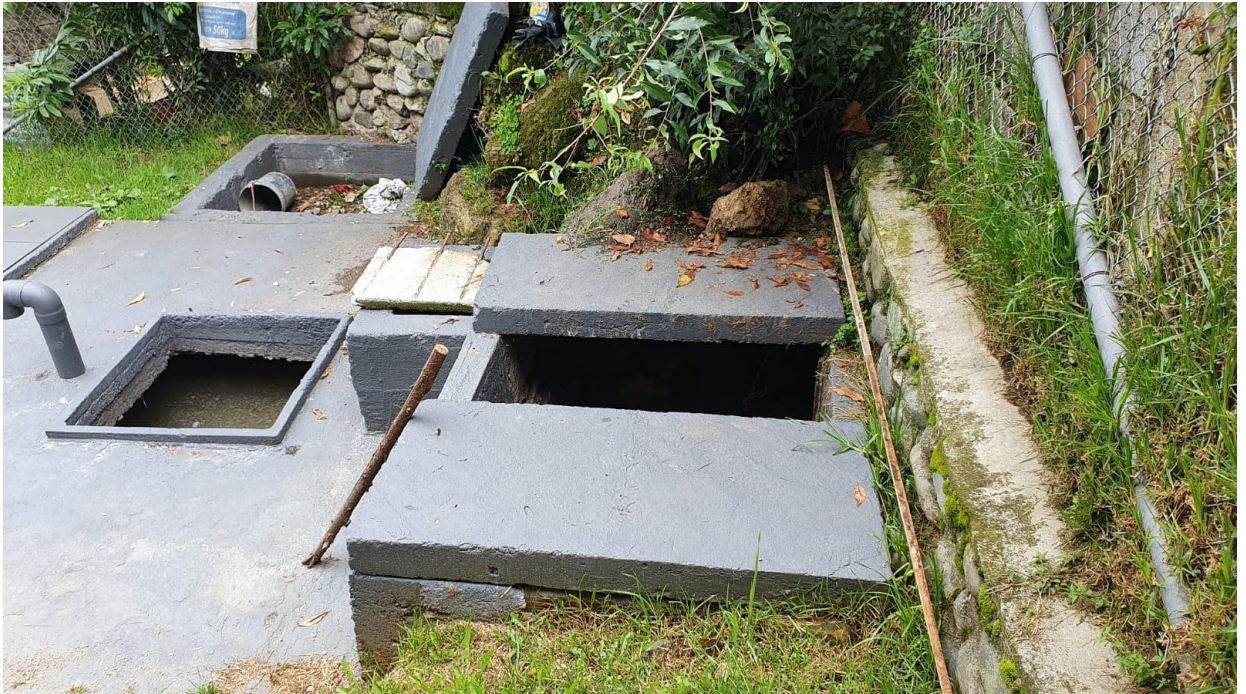
Anexos 18: Caja de entrada de la PTAR "Laureles"
