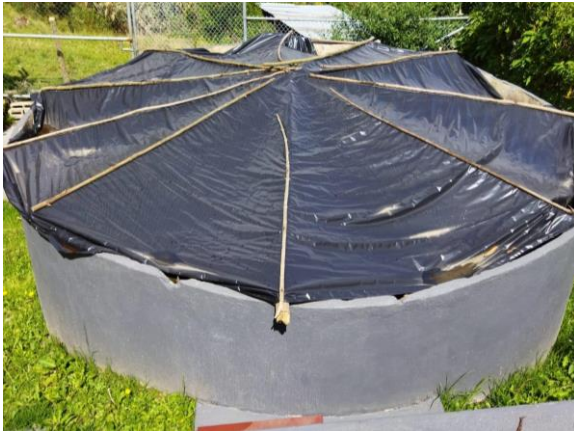
Figura 11: Filtro anaerobio de la PTAR "Laureles" de la parroquia Santa Ana.
