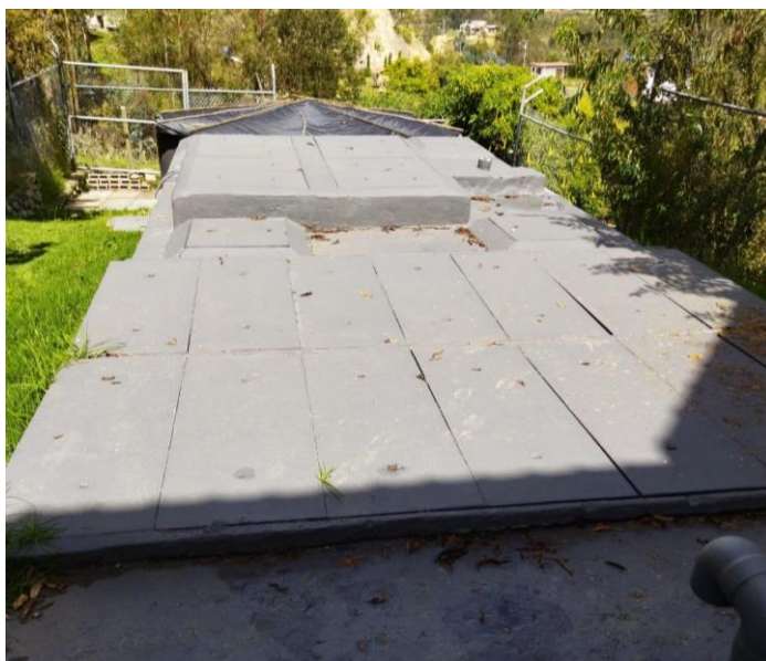
Figura 10:Fosa séptica de la PTAR “Laureles” de la parroquia Santa Ana.
