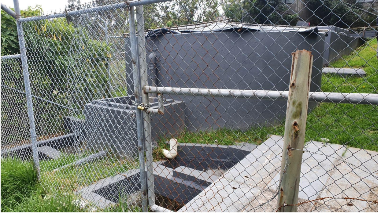
Anexos 16: Filtro Anaerobio de la PTAR "Laureles"
