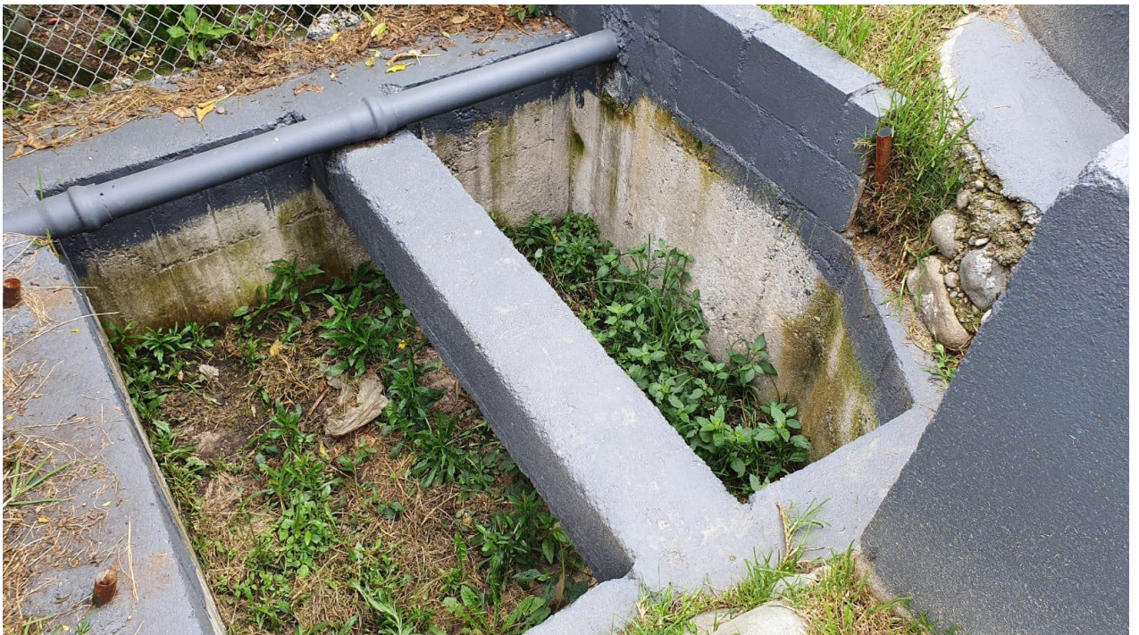
Anexos 17: Interior del filtro anaerobio de la PTAR "Laureles"
