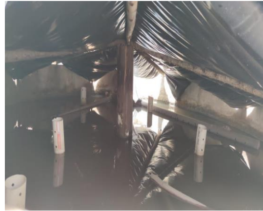
Figura 12: Interior del filtro anaerobio.
