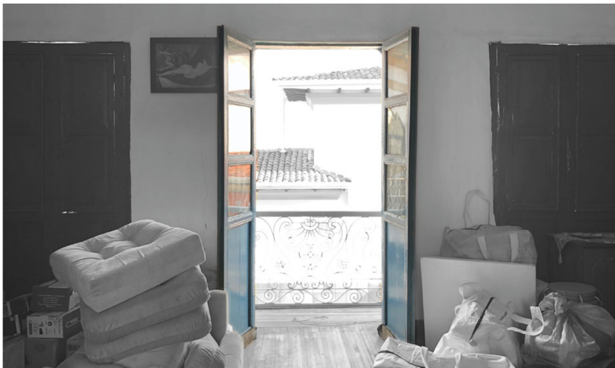
FIGURA 3.9: Estado actual ventanas en la sala edificación BC.s. Fuente y elaboración: Autor
