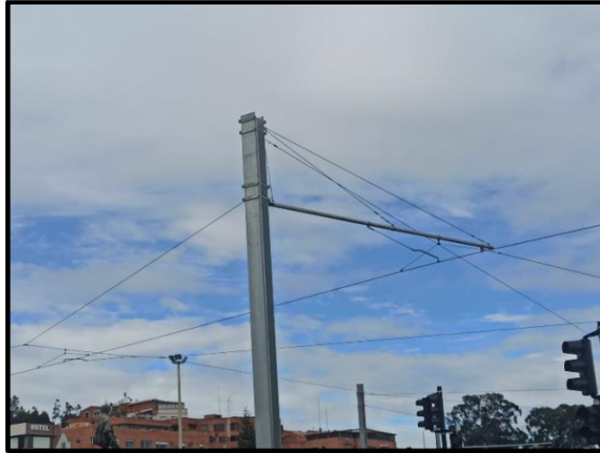
Figura 49: Línea Aérea de Conducción LAC del Tranvía en Américas y Ordóñez Lasso fuente: autores
