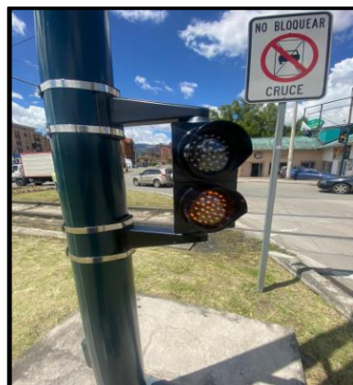
Figura 64 Semaforización auxiliar fuente: autores
