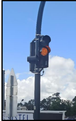
Figura 92: SemafORIZACIÓN auxiliar existente fuente: autores
