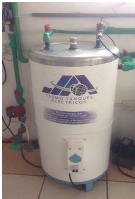
Figura 20 Termo tanque instalado en centro de energía renovable Fuente propia (CER)
