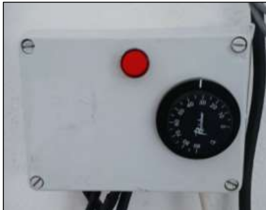
Ilustración 3 sistema de control de temperatura
