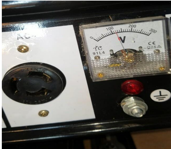
Fig. 61. Voltaje del generador eléctrico a biogás
