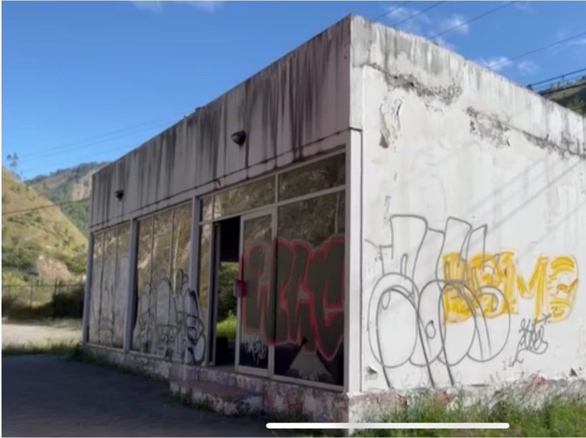
Figura 1: Vandalismo en el antiguo peaje de Chaquilcay.
