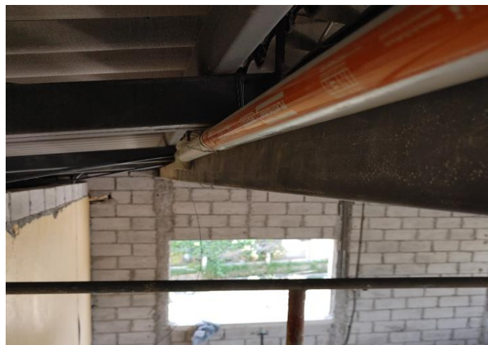
Figura 92. Tendido del conductor en la parte superior de la vivienda. Fuente: Los autores.
