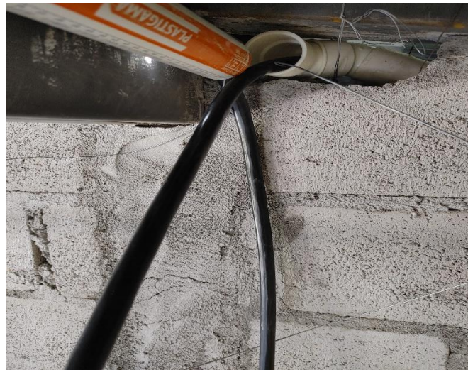
Figura 93. Bajante del conductor eléctrico fotovoltaico hacia el cuarto de máquinas. Fuente: Los autores.
