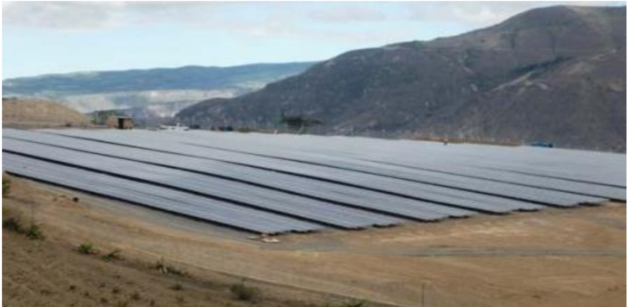
Figura 4. Central Fotovoltaica Imbabura - Ecuador
