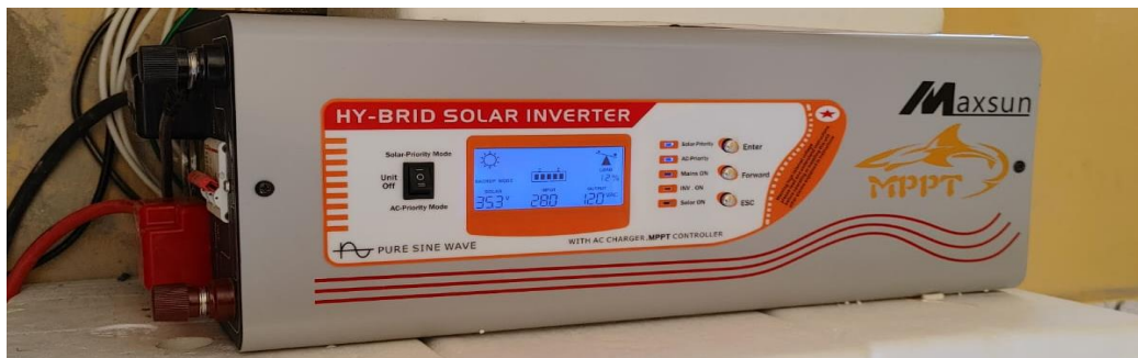
Figura 102. Funcionamiento del inversor ya instalado. Fuente: Los autores.
