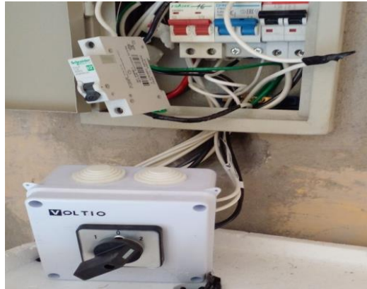
Figura 101. Conexión de selector en la caja de distribución en el cuarto de los equipos. Fuente: Los autores.
