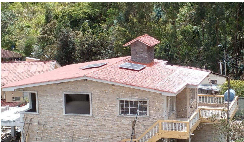
Figura 71. Paneles fotovoltaicos colocados en la cubierta de la vivienda. Fuente: Los autores.
