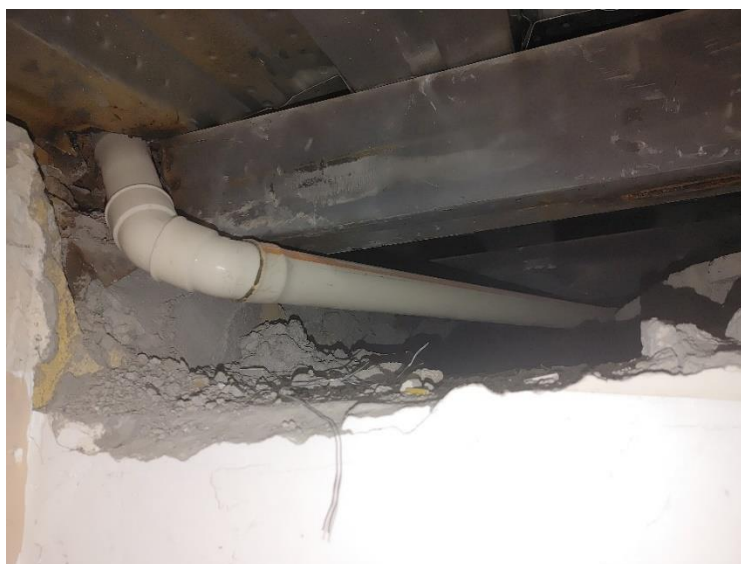
Figura 94. Bajante de llegada hacia el cuarto de máquinas. Fuente: Los autores.
