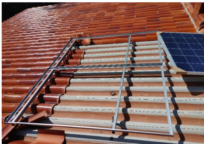
Figura 69. Estructura finalizada y lista para el montaje de las placas fotovoltaicas. Fuente: Los autores.
