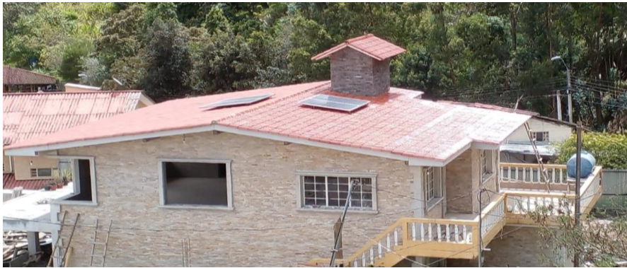
Figura 48. Paneles fotovoltaicos instalados en San Cristóbal Paute, a una inclinación de 12°. Fuente: Los autores
