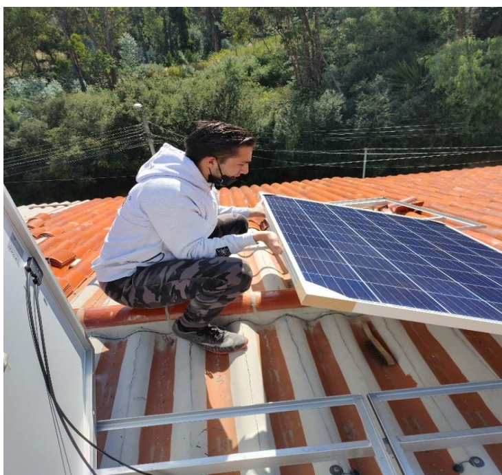
Figura 70. Colocación de los módulos fotovoltaicos en los soportes instalados. Fuente: Los autores.
