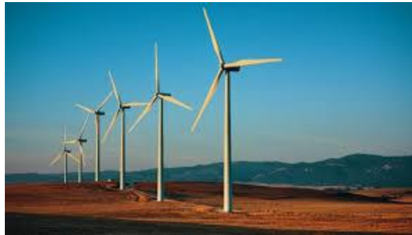
Figura 112. Parque eólico para la generación de energía eléctrica Fuente: (ambienteradio, 2019)
