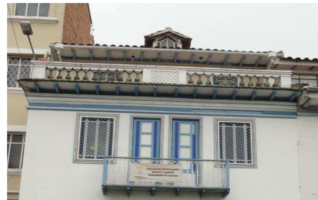
Fotografía No. 26 Daños en fachada frontal de la edificación.
