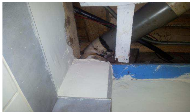
Fotografía No. 27 Daños en cielo raso
