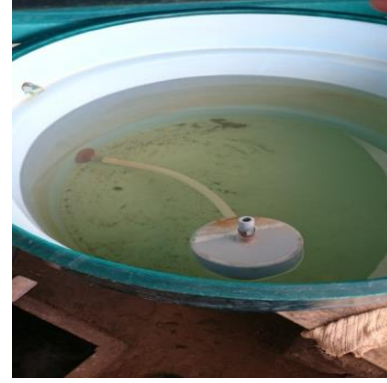
Fotografía #5 – Tanque de Cloración 250lt.
