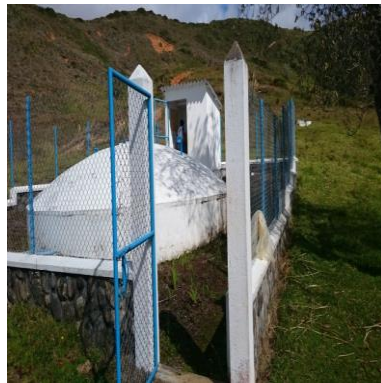
Fotografía #2 – Tanque Almacenamiento
